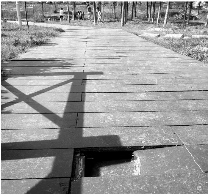
芙蓉湖旁边的木栈道有一处木板断裂,存在安全隐患。 记者 万誉 摄
