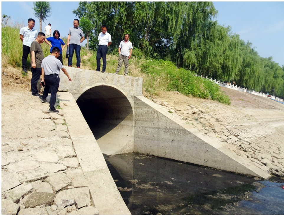
清潁河西岸建安桥北侧排水口,6月18日上午依然有淡黄色的水流出。记者 吕正子 摄
