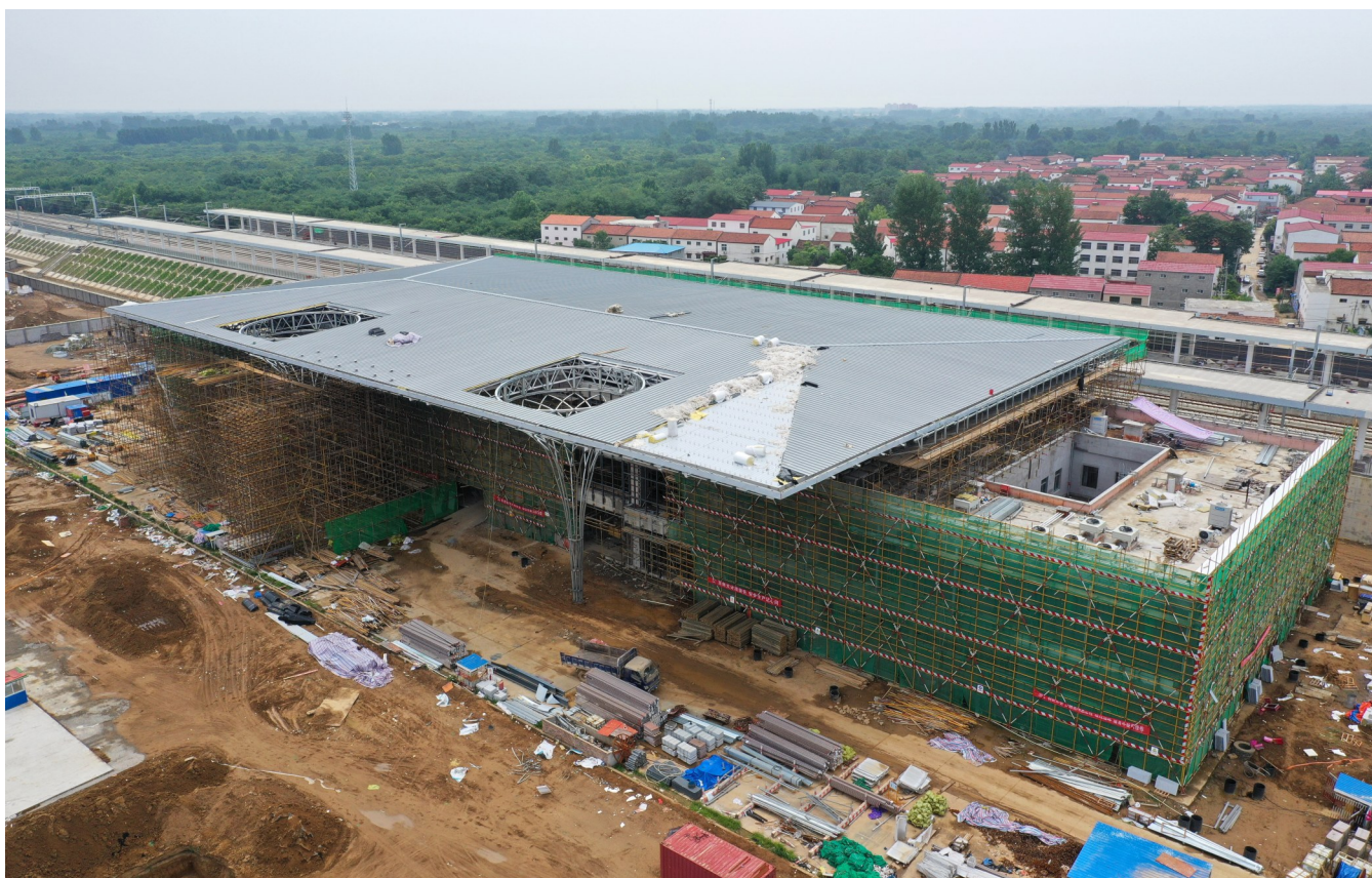
6月25日,郑合高铁鄢陵站站前广场配套设施、绿化带清障等工程按照既定时间节点有序推进。郑合高铁8月份便可联调联试、进行机车试运行,建成后将有力助推许昌经济发展。 记者 牛书培 摄
