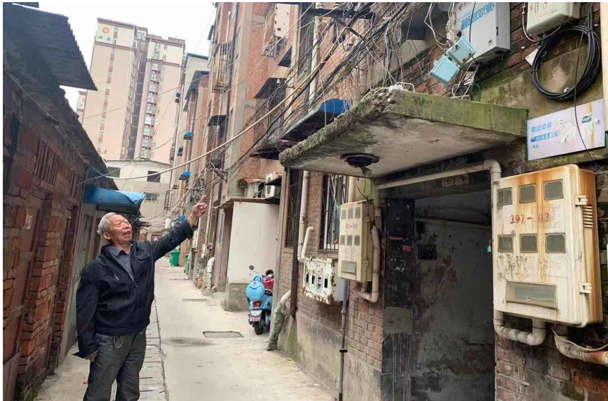
居民鲁长根指着破旧的墙体给记者看。
