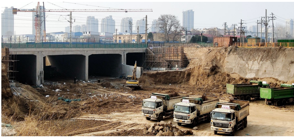
瑞贝卡大道与阳光大道连通工程工地,混凝土箱涵已架空顶进到位。记者 吕正子 摄
