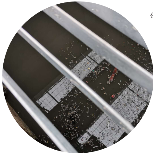
雨水泵站进行雨污分流。
