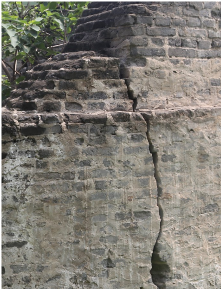
“王井”的砖圈很厚，但仍被水流冲出裂缝。
