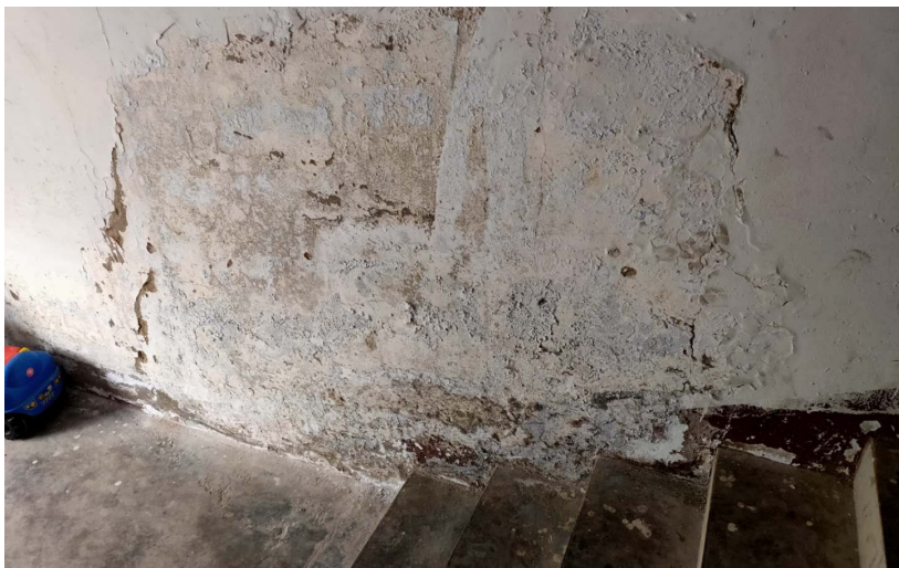
8月12日,市区金质西湖花园,楼道墙体大面积脱落。记者 张汉杰 摄
