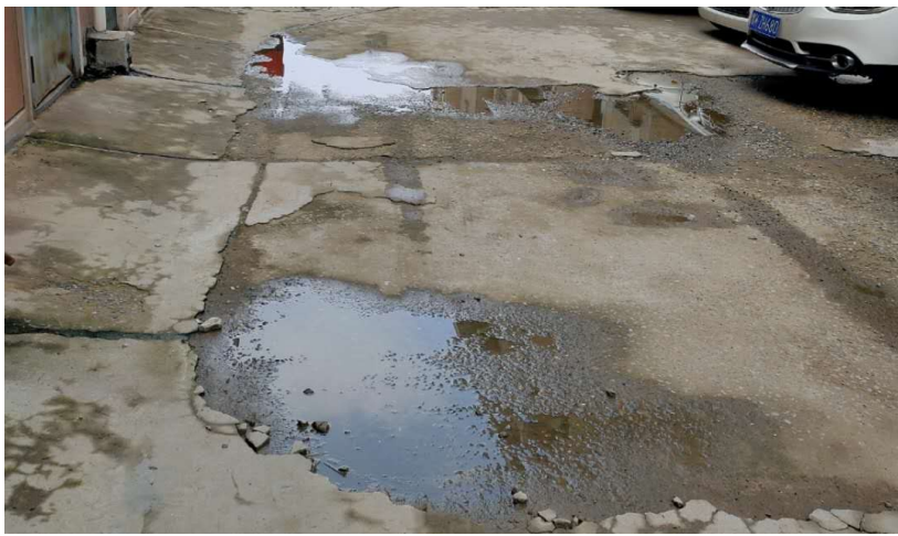
8月11日上午,市区中原文化小区,道路破损严重。记者 张汉杰 摄
