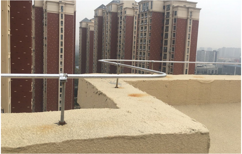
锦绣佳苑小区楼顶的避雷带。记者 张辉 摄
