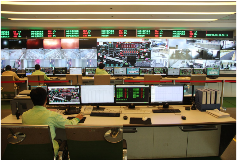
图为许昌旺能环保能源有限公司集中控制室。魏东雅 摄
