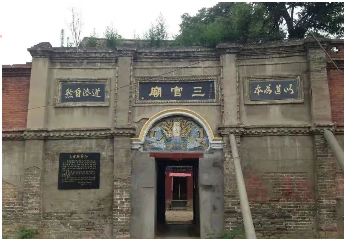
始建于唐贞观年间的三官庙庙门在去年“7·20”特大暴雨中被冲毁 资料图片
