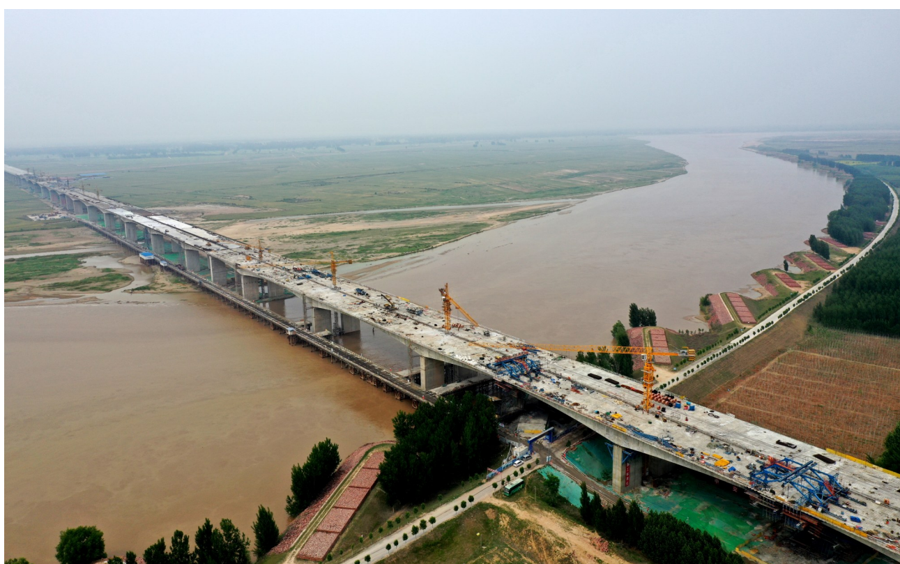
5月16日,由中交一公局承建的河南官渡黄河大桥主桥顺利合龙。官渡黄河大桥设计全长7377米,是国道107改线的“咽喉”工程。图为当天记者用无人机拍摄的官渡黄河大桥施工现场。新华社记者 朱祥 摄
