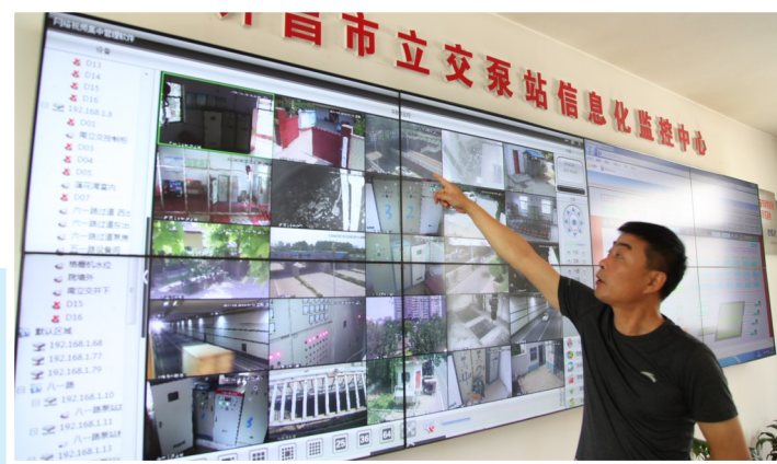
许昌市立交泵站信息化监控中心
