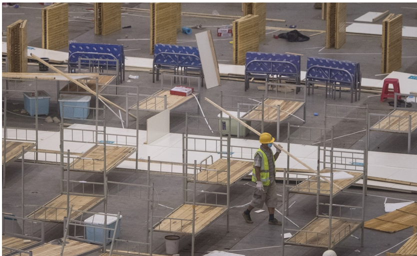
7月29日,工人对武汉客厅方舱医院进行拆除作业,预计工作需要两三天完成。
