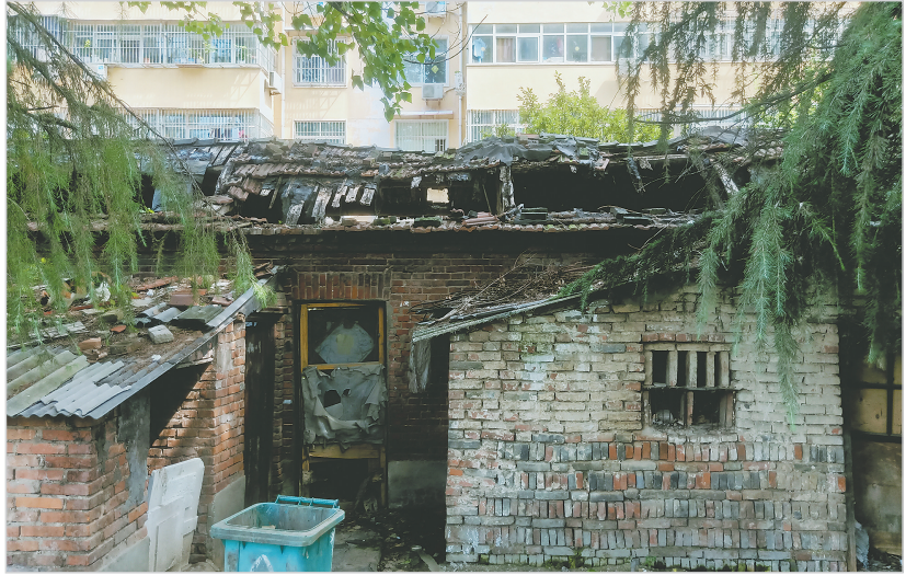
位于市区毓秀南路许扶运河桥西的危旧房屋
