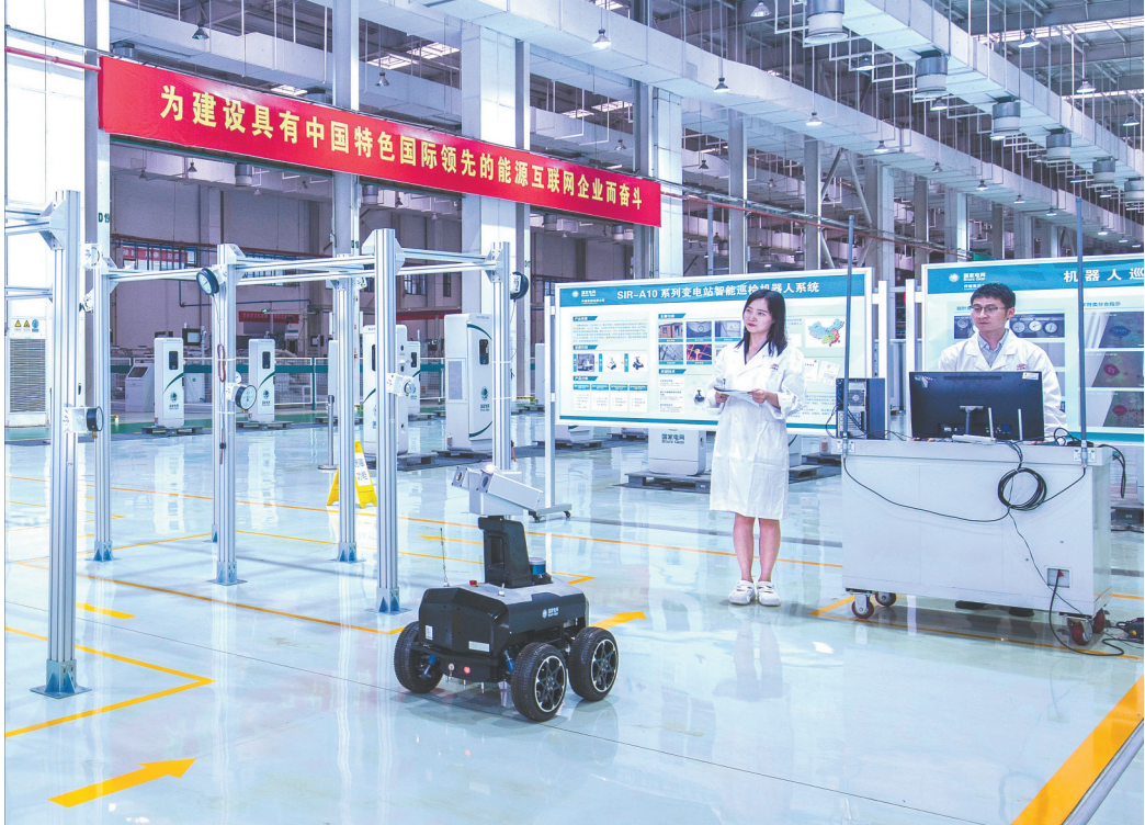
8月4日,许继电源有限公司技术人员正在模拟实验场进行新一代智能巡检机器人系统测试。据介绍,该款机器人具有高频率、自主化、快捷高效等特点,可为无人值守的变电站进行室内外设备巡视,提升变电站智能化管理水平。本报记者 乔利峰 通讯员 魏众摄
