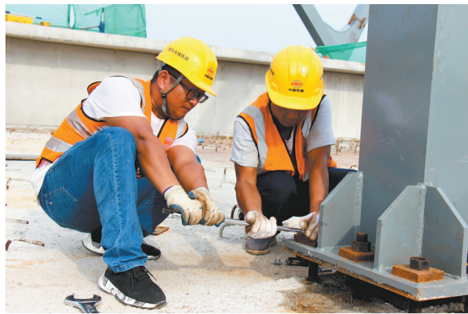
8月14日,在郑许市域铁路项目农大路站钢结构施工现场,工人们冒着炎热,正在用液压千斤顶调整两个连接梁的平整度,以便螺栓安装。朱庆安摄
