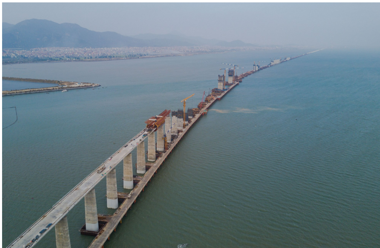
这是在新建福厦铁路福州湾跨海大桥建设现场(11月2日摄,无人机照片)。近日,新建福厦铁路福州湾跨海大桥作业加紧推进,施工单位克服入秋以来海上风浪大、昼夜温差大等困难,确保工程进度。福厦高铁是我国首条跨海高铁。
