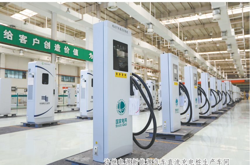
许继电源新能源汽车直流充电桩生产车间
