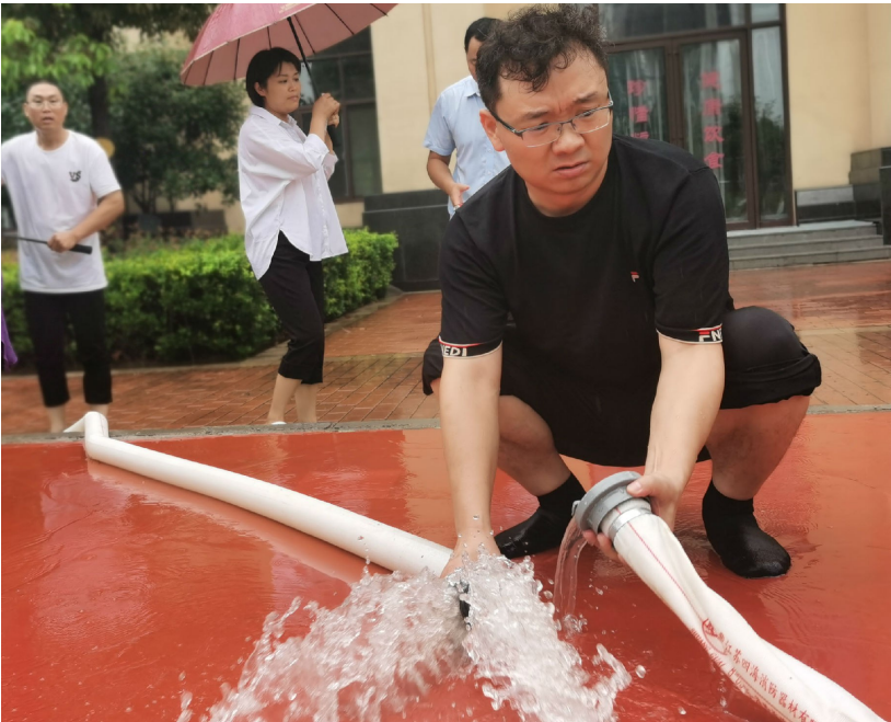
远航物业党支部组织委员、总经理毛相雨用排污泵排水。 齐学群 摄 “经理，地下车库突然出现一处 漏水点，漏水严重，现在负二层设备
