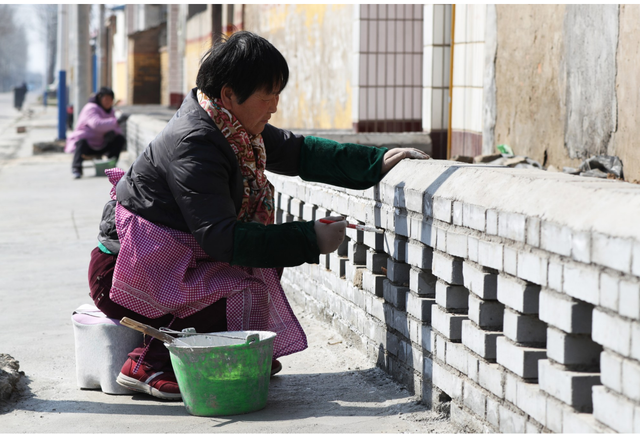
2月27日，建安区陈曹乡袁庄村村民在粉刷街道新建围墙。“村组卫生好了，群众的健康才能有保障。大家身体健康了，才有精力搞发展。”近年来，建安区聚焦农村人居环境整治难点，坚持“街道主管、村组主建、多方参与”，做好组织建设、示范推动、文化引领，统筹推进农村人居环境提升改造，做到建设前群众赞成、建设中群众参与、建成后群众满意、运行中管理规范，不断改善农村人居环境。
