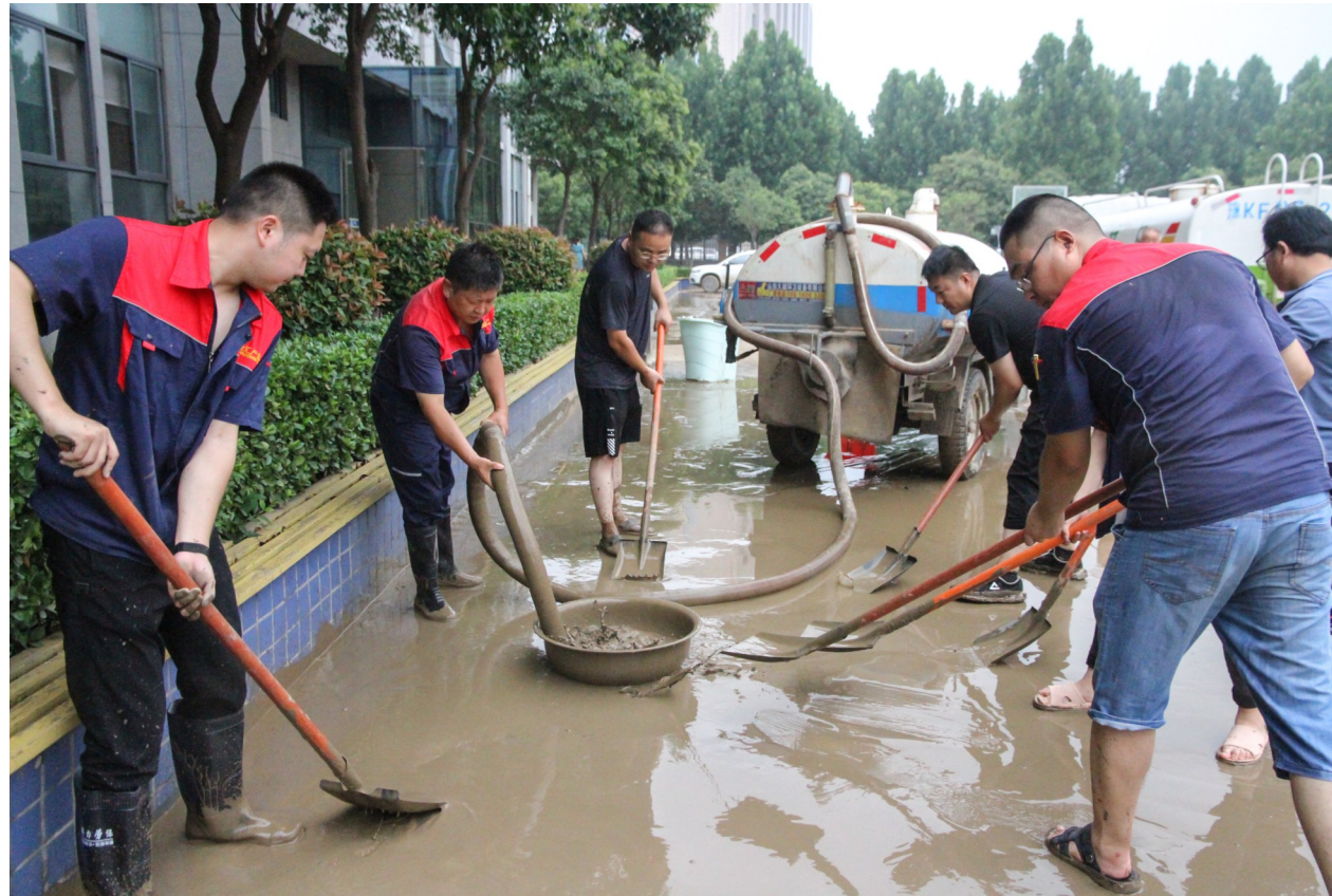
去年7月下旬,洪涝灾害发生后,许昌金汇中起不锈钢科技有限公司工人进行清淤作业。资料图片
