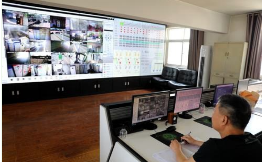
对城市给排水进行实时调度。
