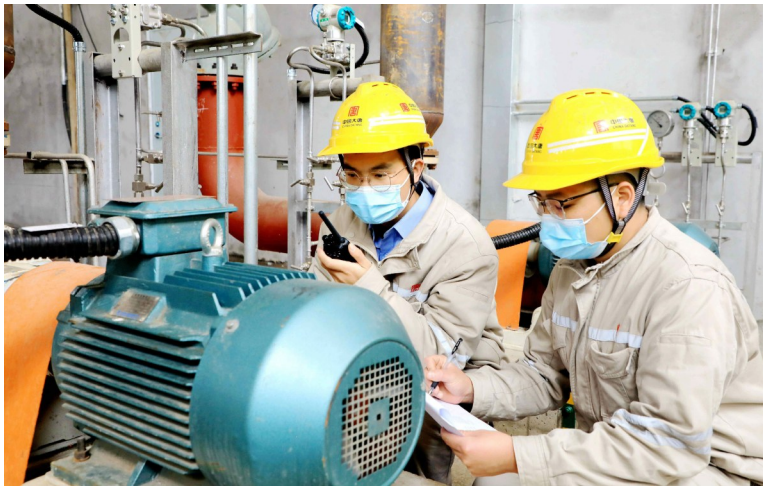
11月22日,许昌龙岗发电有限责任公司运行人员对供热设备进行巡查,确保供热系统安全运行。签约摄影师 叶剑飞 摄
