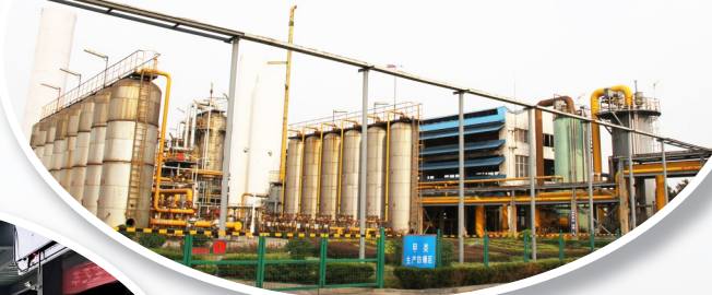
河南平煤神马首山化工科技有限公司2亿立方米焦炉煤气制氢装置
