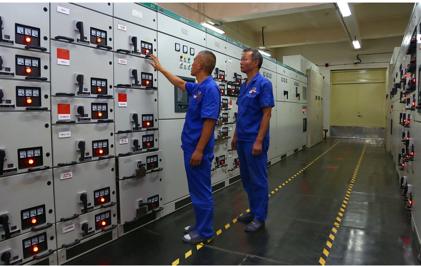
远航物业工程人员巡检设备。资料图片
