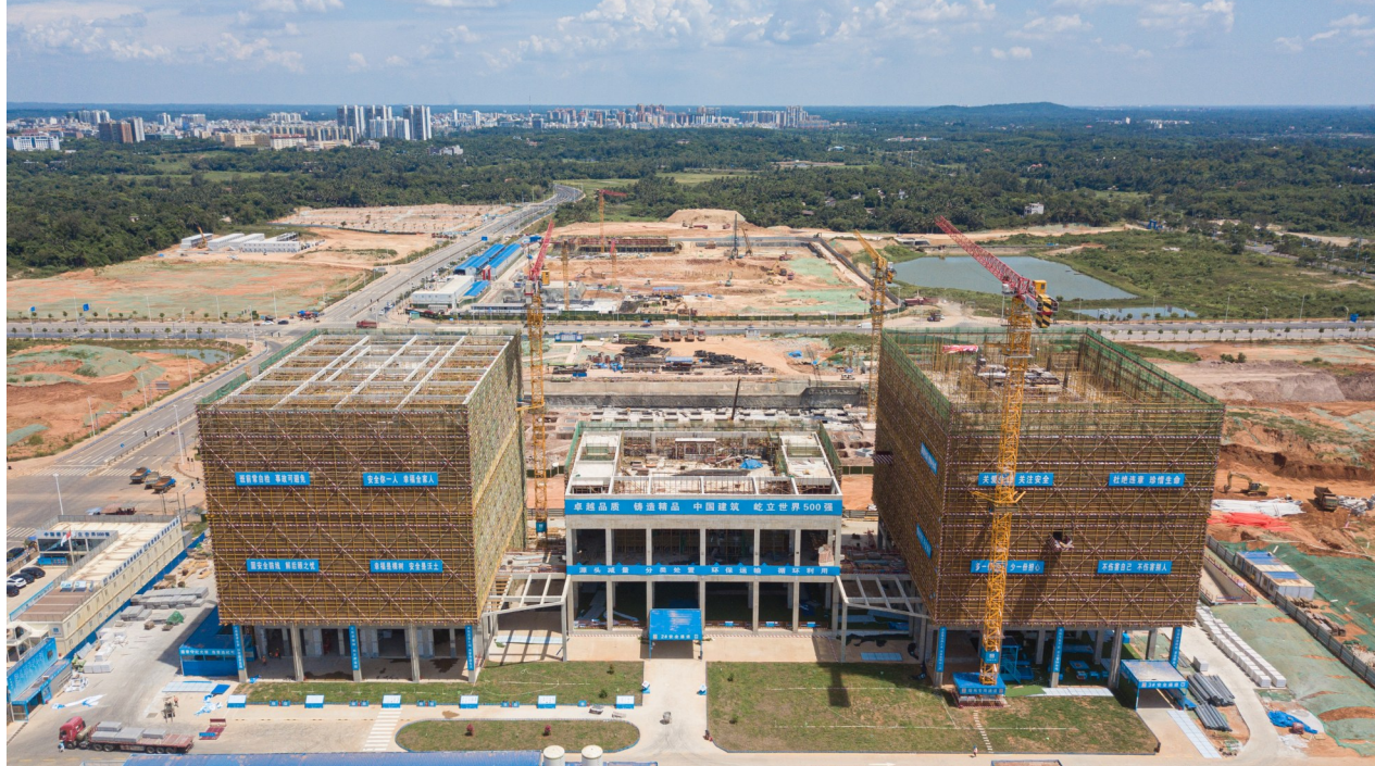
7月15日在海南文昌国际航天城拍摄的在建设中的遥感卫星项目(无人照照片)。近日,位于海南自贸港重点园区——海南文昌国际航天城内的遥感卫星项目主体结构封顶,工人正在进行隔墙、消防、机电等施工。该项目将新建数据应用中心并增配遥感卫星国际数据服务设备、金砖遥感卫星星座建设管理设备等多套设备。项目建成后,将进一步加强金砖国家之间空间信息产业合作,提升我国空间信息产业市场化、国际化水平。新华社发
