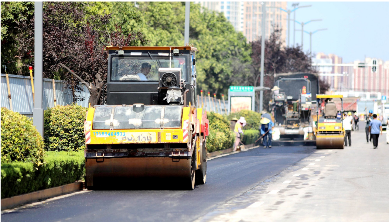
8月29日,市区莲城大道,工人们正在进行路面硬化。目前,我市中心城区“汽改水”项目稳步推进,部分路段供暖管道已铺设到位,正加紧恢复路面,方便市民出行。本报记者 乔利峰 摄
